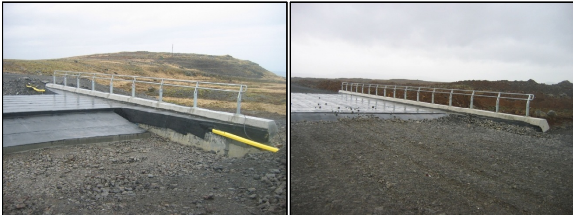
Mynd 1. Myndir frá Reykjanesbraut, sýna núverandi verklag við einangrun brúardekks. Myndirnar eru frá verktaka.
